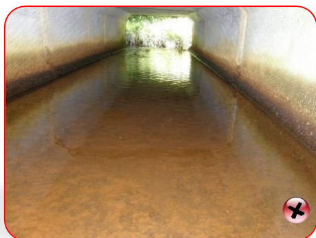
Lame d'eau insuffisante
