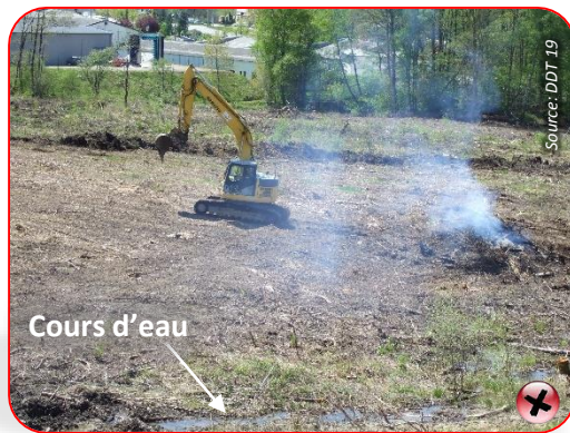
Destruction des berges et érosion des sols
